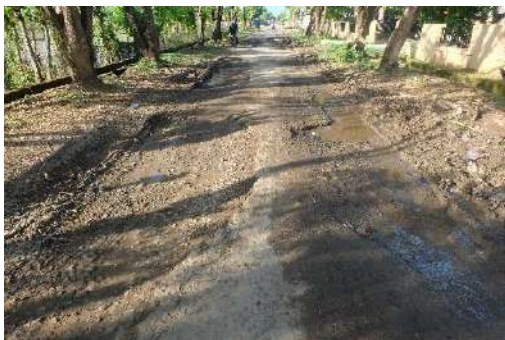
Gambar 4. Kondisi Jalan dengan kontruksi tanah
