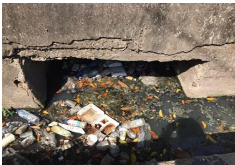
Gambar 10. Kondisi drainase di sekitaran Jl. Pengayoman
