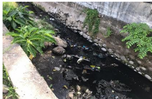
Gambar 8. Kondisi drainase di Jl. Mirah Seruni
