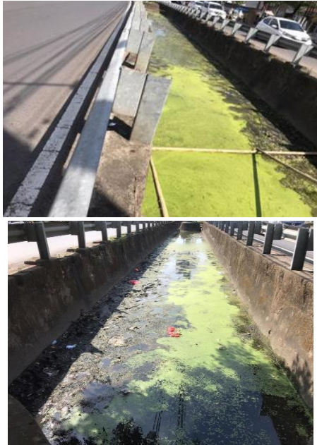
Gambar 9. Kondisi drainase di sekitaran Pasar Segar
