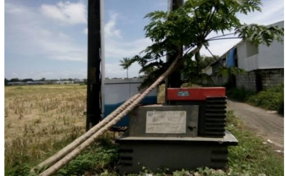
Gambar 6. Kondisi Eksisting Gardu Listrik Desa Kanjillo
