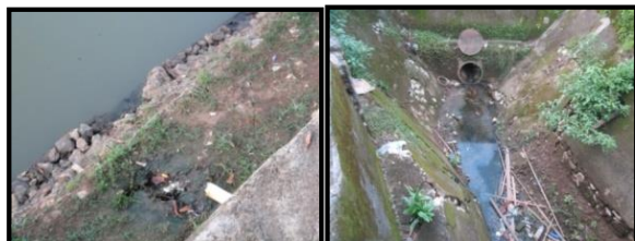
Gambar 10. Kondisi saluran pembuangan air limbah
