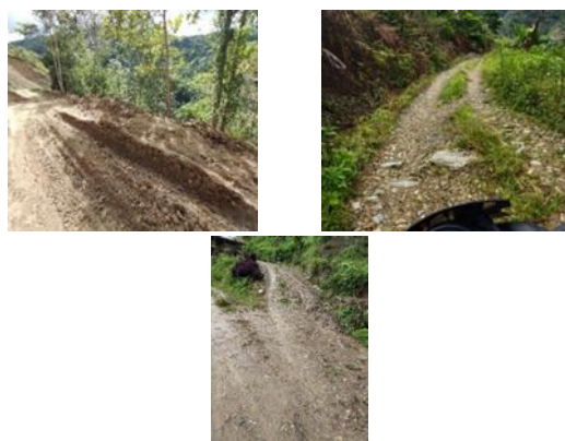
Gambar 5. Kondisi Jalan Kecamatan Latimojong
