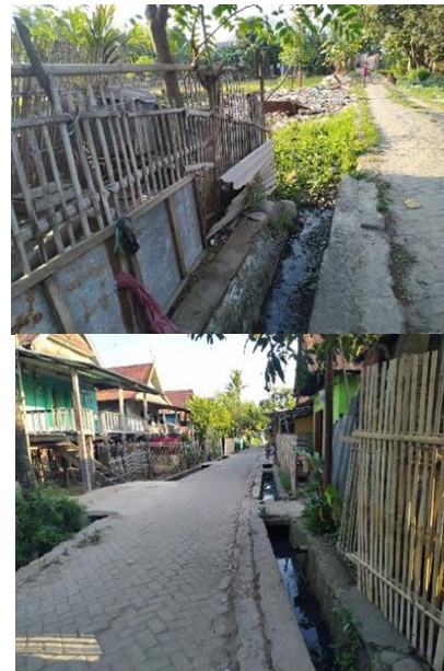
Gambar 6. Kondisi Drainase di Kampung Beru RW VII Gusung Sarombe
