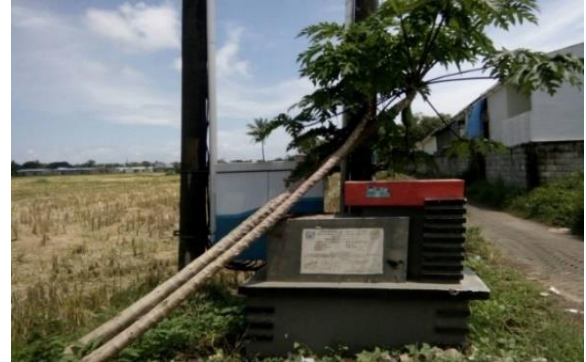
Gambar 6. Kondisi Eksisting Gardu Listrik Desa Kanjillo
