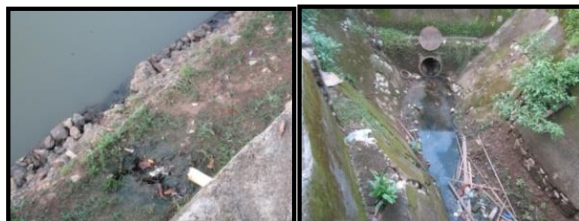
Gambar 10. Kondisi saluran pembuangan air limbah
