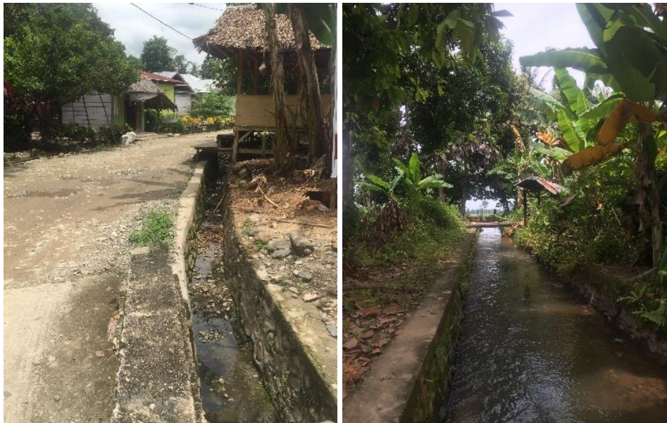
Gambar 8. Kondisi drainase Kecamatan Telluwanua
