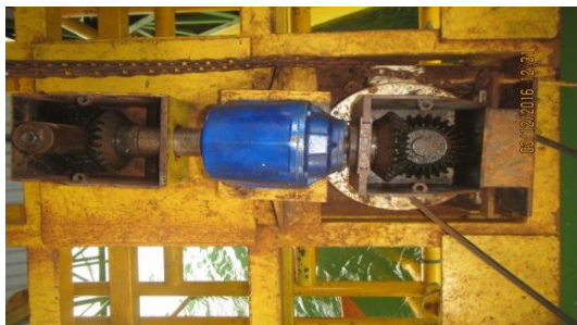
Gambar 6. Sistem hubungan transmisi antara generator dan poros rotor (untuk satu generator)
